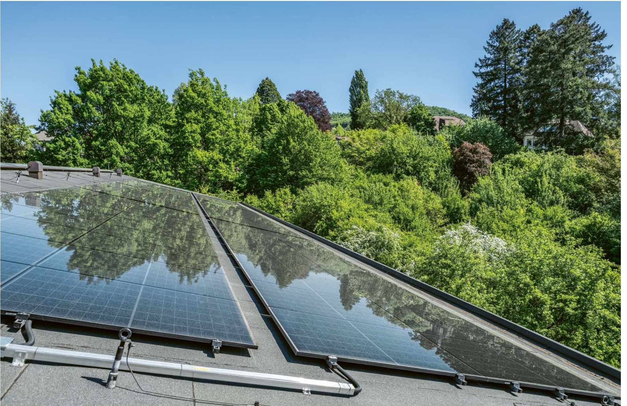
Die Dachflächen eignen sich hervorragend für die Installation der Solarpanele | Foto: Kathrin Schulthess
